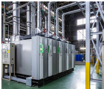
나고야 제작소 내의 증기 보일러 설비. 제조사 전용(기타다). OPC UA는 제조 현장의 네트워크와 정보 감시 시스템이 필요한 설비였으나, PLC를 접속함으로써 손쉬운 정보 수집이 가능해졌다.
