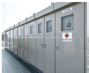
나고야 제작소의 고압 변전 설비. 이러한 감시 대상 설비가 방대한 부지 내에 흩어져 있어 통합적인 감시가 필요했다.
